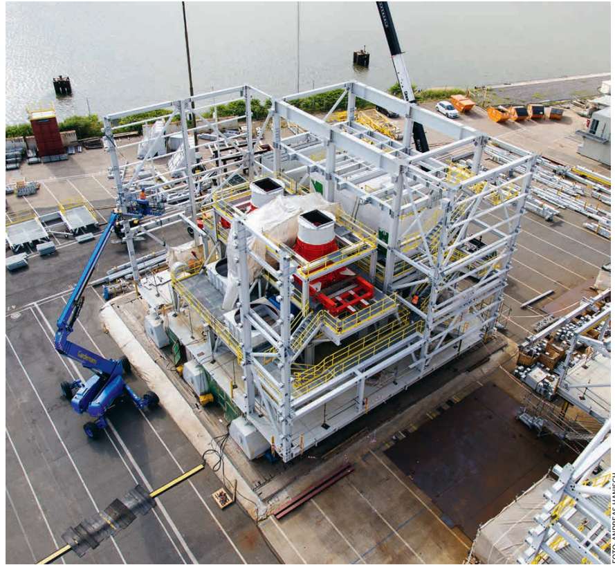
Bei dem Pilotprojekt wurde die Projektlogistik rund um die Montage dieser Sieb- und Brechanlage auf der ABC-Halbinsel in Bremerhaven optimiert.
